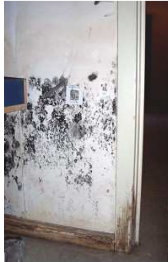
Vandskadedet gipsvæg i kælder med kraftig skimmelvækst.
